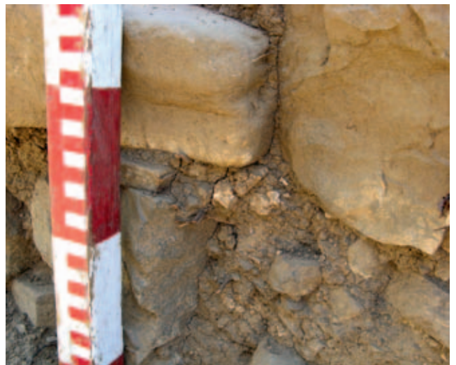
Рис. 1.24. Северный вход в храм. Фрагмент. Шов между кладками первого и третьего строительных периодов, остатки известковой штукатурки на восточном откосе проёма. Вид с запада.
